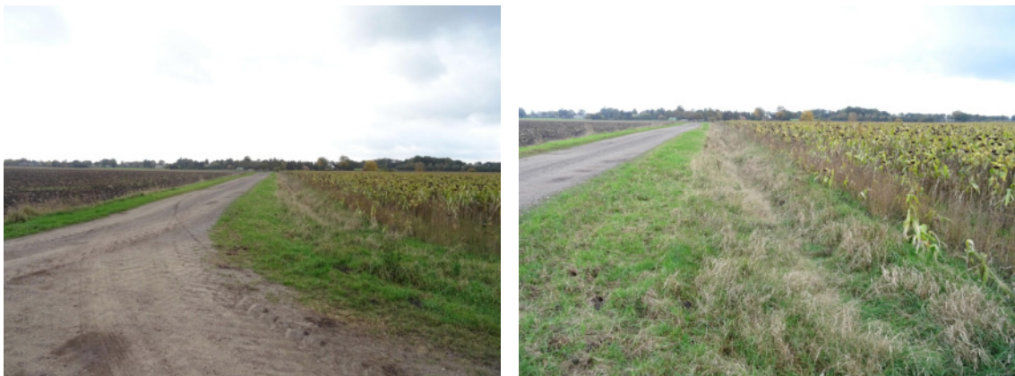
Abb. 7: betroffene Entwässerungsmulde im Abbiegebereich Westerbeck/landwirtschaftlicher Weg
