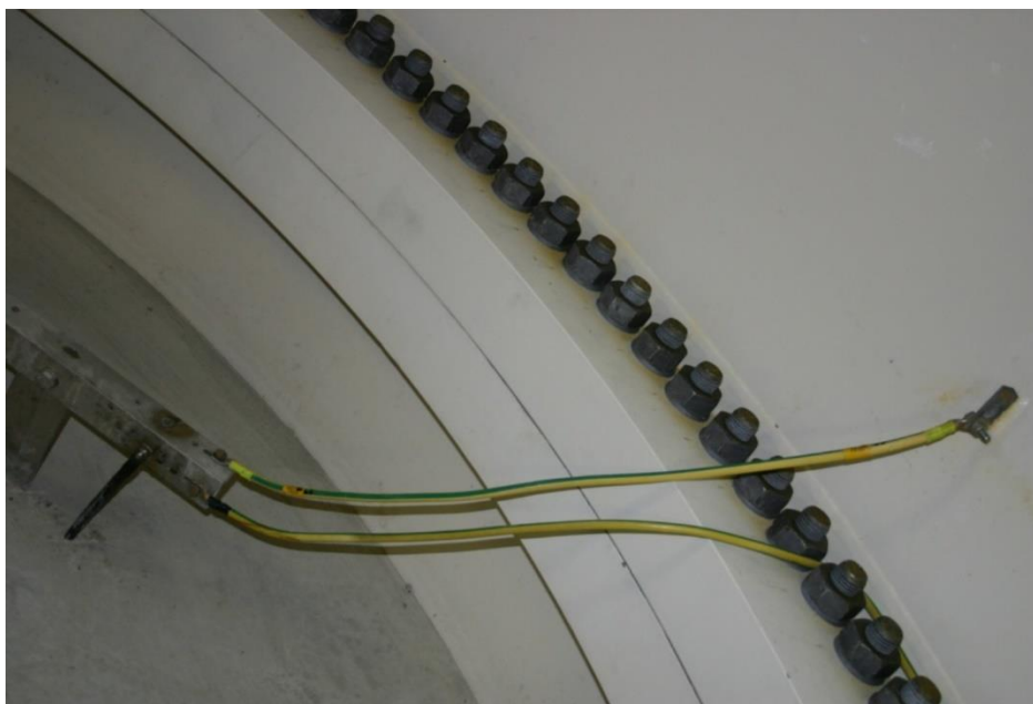
Abbildung 3-7: Verbindung zwischen dem Turm und der Haupterdungsschiene
