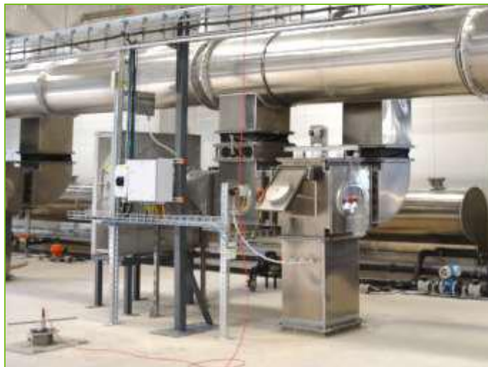
Abb. 4: Belüftungseinheiten mit zentralem Frisch- und Abluftkanal sowie Tunnelventilatoren (Quelle: Eggersmann Anlagenbau GmbH)
