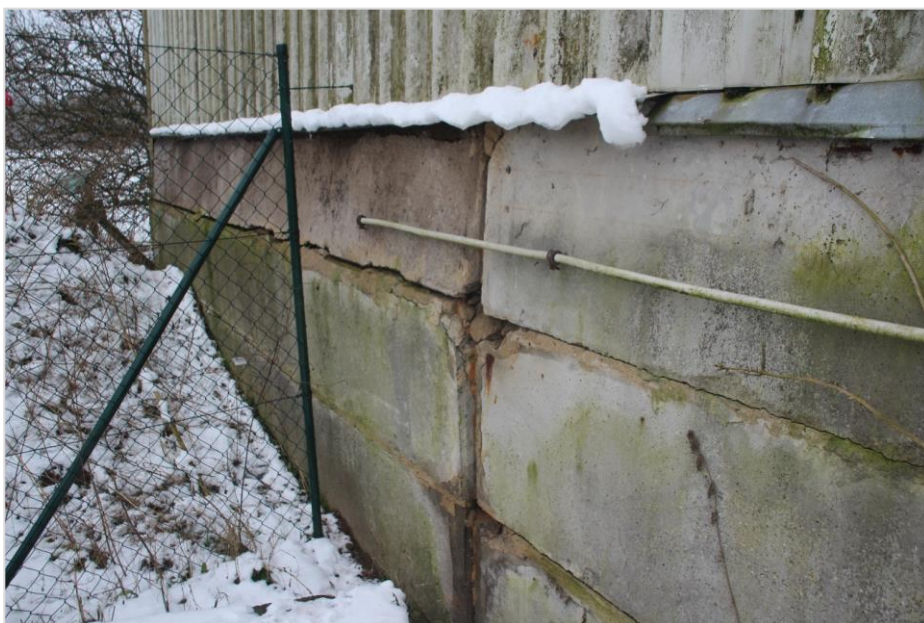
ungeeignete Spaltenstrukturen im Betonsockel der Halle 3
