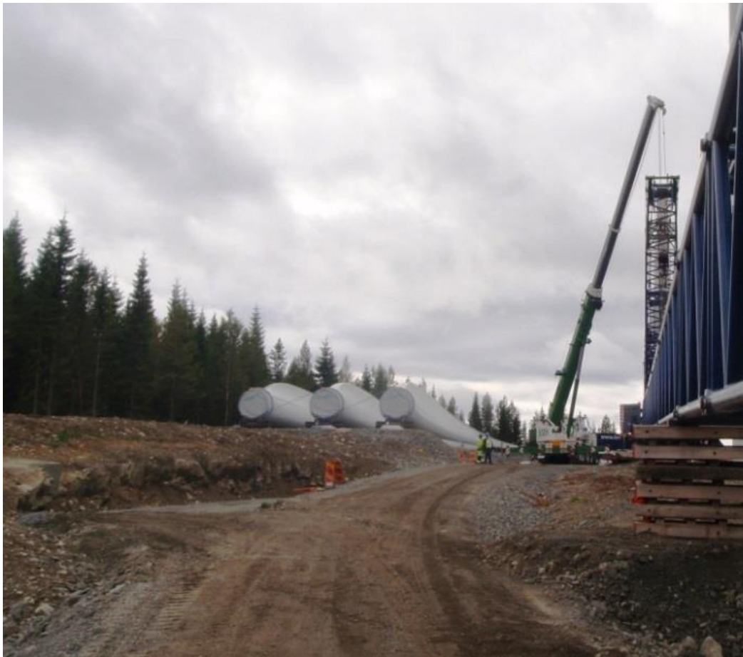
Abbildung 16: Beispiel für eine befestigte Stellfläche q2 auf hügeligem Gelände. Ungeachtet des Gefälles der angrenzenden Straße, muss q2 in jedem Fall geebnet sein.
