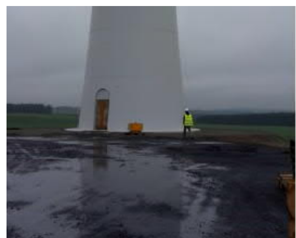
Abbildung 19: Zwei Beispiele für einen eingerichteten Service-Zugang zur WEA
