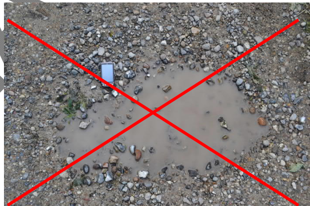
Abbildung 3: Eine gut instandgehaltene Standortstraße muss frei von Schlaglöchern sein.
