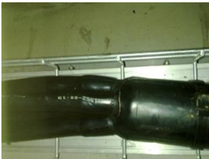
Abbildung 7-1: Risse im Schrumpfschlauch des Mittelspannungskabels.
