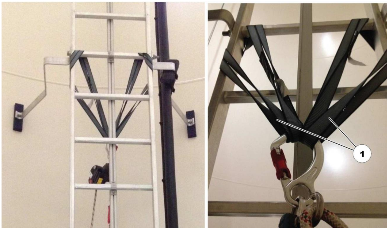
Abbildung 5.24: Abstiegsvorrichtung mit zwei Schlingen an der Leiter befestigt
