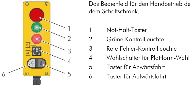
Abb. 11: Bedienfeld im Servicelift
