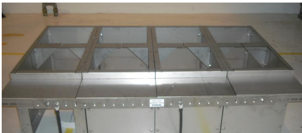
Abbildung 4-16: Erdungskabel (Kabelschuhe) verbunden mit der Haupterdungsschiene am Grundrahmen einer Schaltanlage mit vier Schaltfeldern
