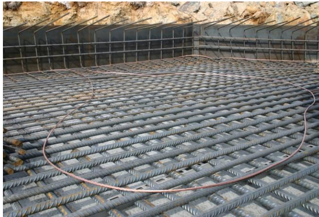
Abbildung 4-7: Locker verteiltes überschüssiges Erdungskabel
