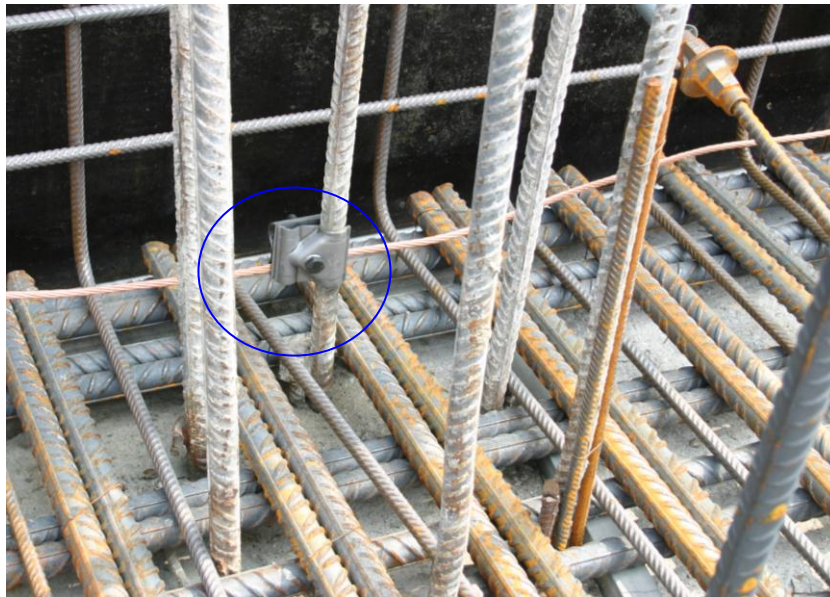
Abbildung 6-1: Mittels einer Anschlussklemme mit dem Stahlbewehrungsstab des Tiefgründungspfahls verbundenes Kupfererdungskabel
