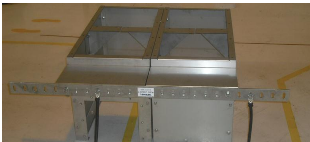
Abbildung 4-18: Erdungskabel (Kabelschuhe) verbunden mit der Haupterdungsschiene am Grundrahmen einer Schaltanlage mit zwei Schaltfeldern
