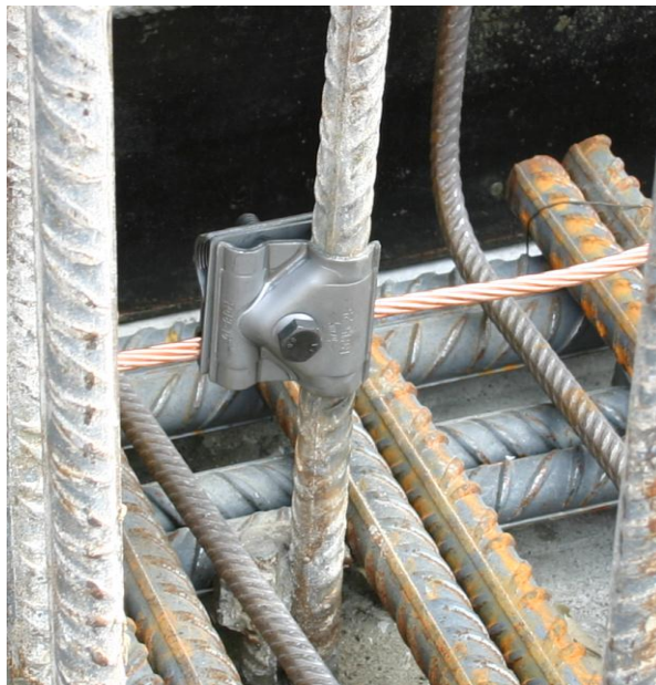
Abbildung 6-3: Mittels Anschlussklemmen mit den vertikalen Stahlbewehrungsstäben der Tiefgründungspfähle verbundenes Kupfererdungskabel
