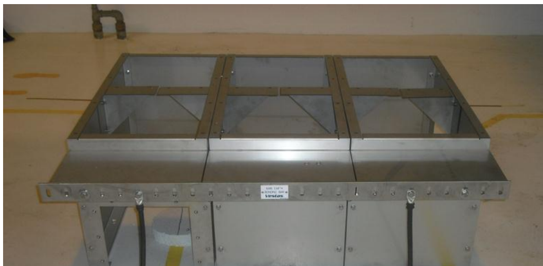
Abbildung 4-17: Erdungskabel (Kabelschuhe) verbunden mit der Haupterdungsschiene am Grundrahmen einer Schaltanlage mit drei Schaltfeldern
