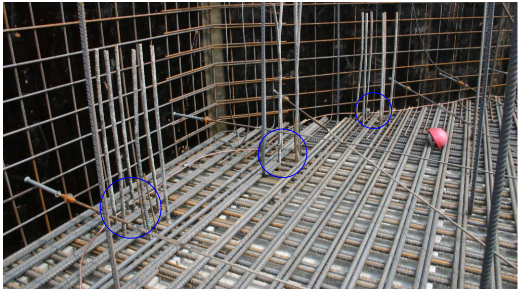
Abbildung 6-2: Mittels Anschlussklemmen mit den Stahlbewehrungsstäben der Tiefgründungspfähle verbundene Kupfererdungskabel
