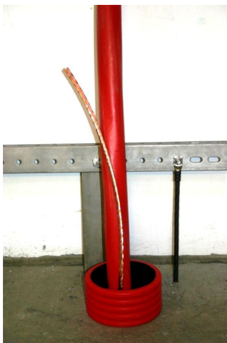
Abbildung 7-1: Zusammen mit dem Mittelspannungskabel durch die Kunststoffeinführungsrohre in den Turm eingezogenes Erdverbindungskabel
