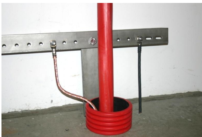
Abbildung 7-3: Mit der Haupterdungsschiene verbundenes Erdverbindungskabel
