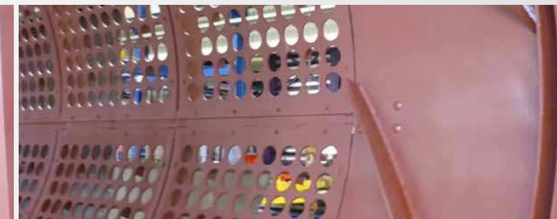
Einlauf der Trommel mit Labyrinthdichtung und Blindboden
