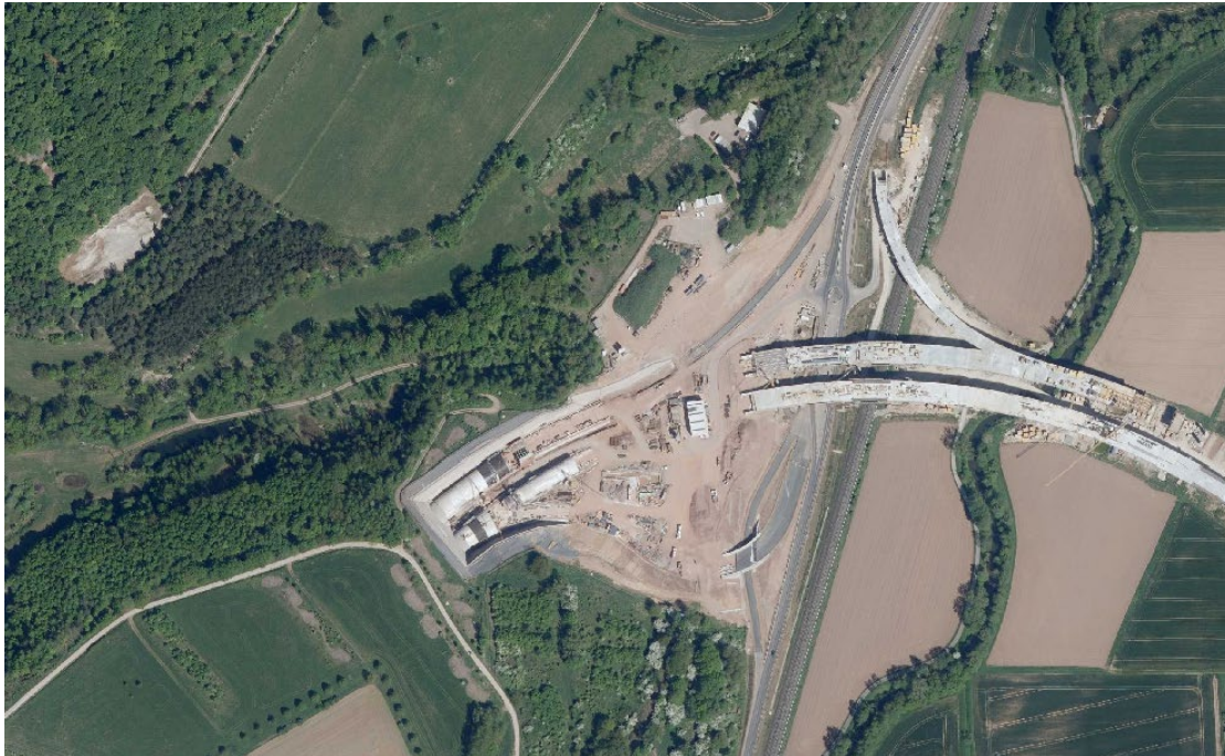
Abbildung 8: Totalzerschneidung des alten Bahndamms parallel der B27 auf ca. 300 m Länge durch die Baustelle der A44. Aus: GoogleMaps, Mai 2021.
