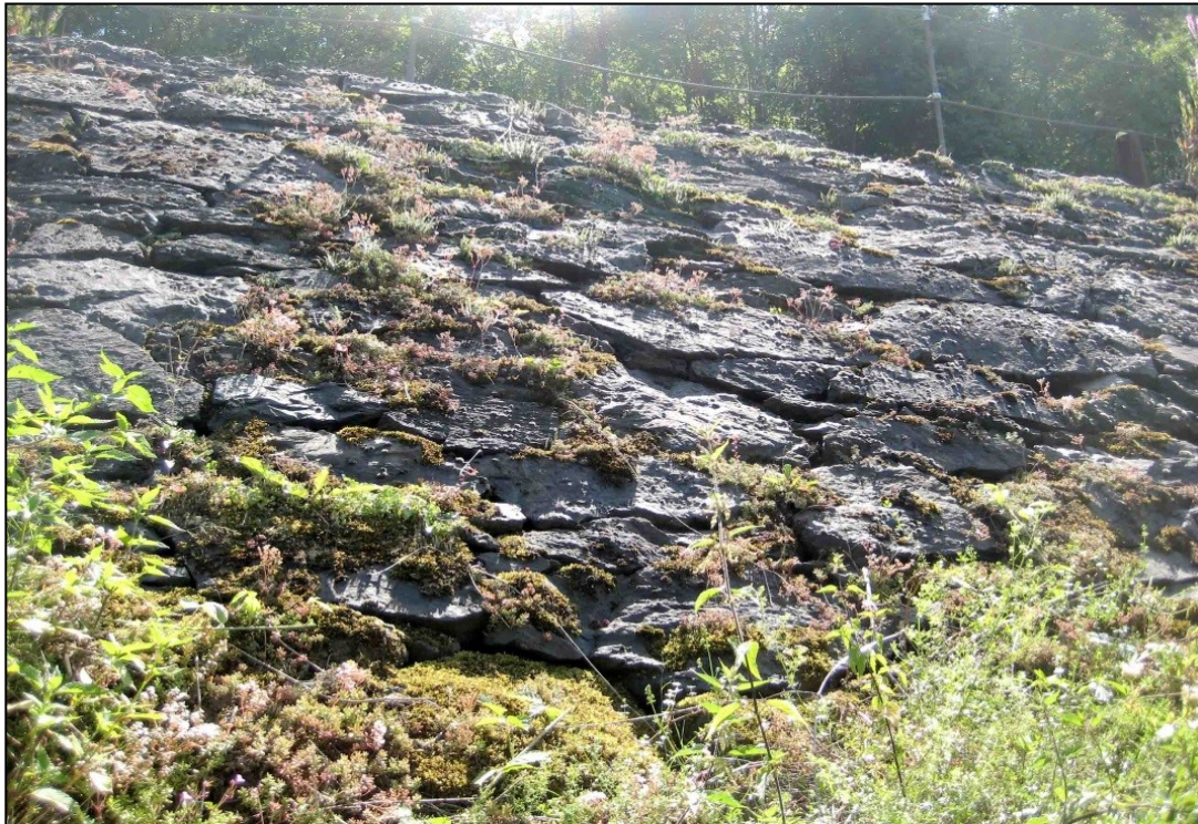
Abbildung 29: Mauervegetation an Bahnstützmauer
