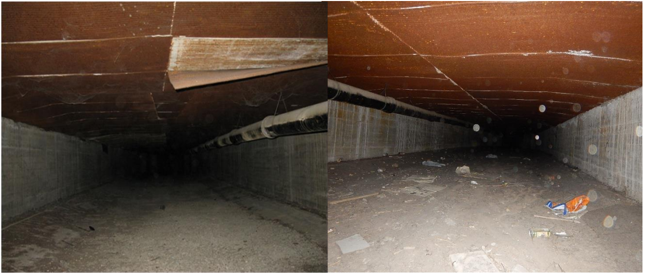
Abbildung 3: Brückeninneres bei der Sichtkontrolle im April 2011 sowie im Juni 2016
