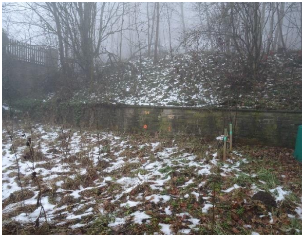
Sandsteinmauer im Bereich der Zufahrt, davor Ruderalflur. Die Mauer wird ebenso wie die Sandsteinmauer an der Straße beseitigt und nach Bau neu errichtet,.
