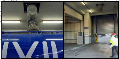
Verladung Rauchgas-Reinigungsrückstände/ Verwiegung RGR und Schlacken (bei geschlossenen Ein-/ Ausfahrten)
