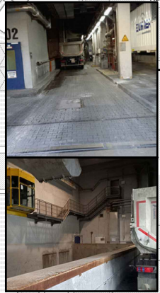
Verladestraße Schlacke/ Verladung Schlacken mit Schallengreifer
