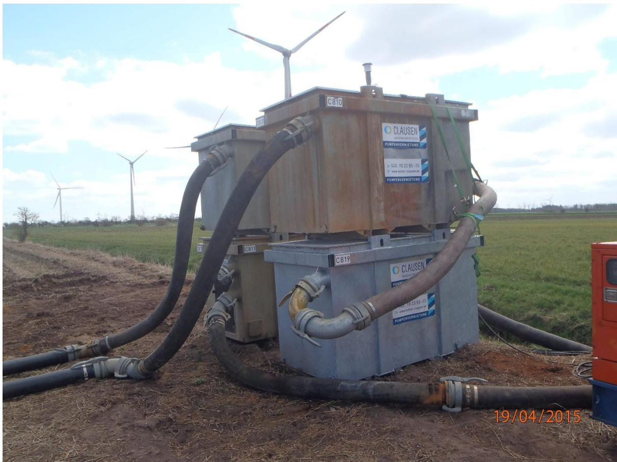
Abbildung 20: Beispiel einer Filtrationsanlage für Eisen und Mangan (Quelle: Website Fa. Clausen: https://walter-clausen.de/pumpenvermietung/wasseraufbereitung )
