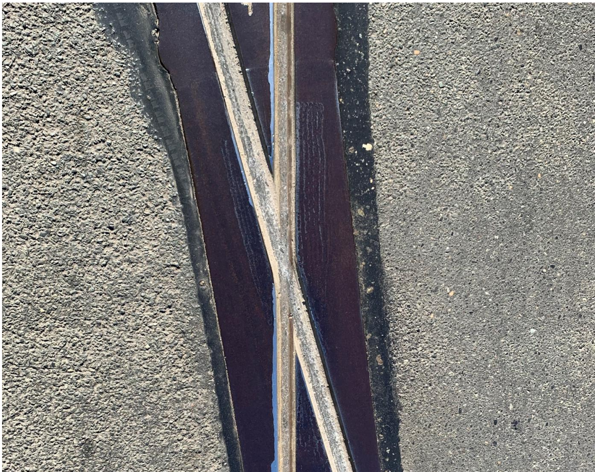
Abbildung 10: Verschleiß am Gleisdreieck Pirckheimerstraße
