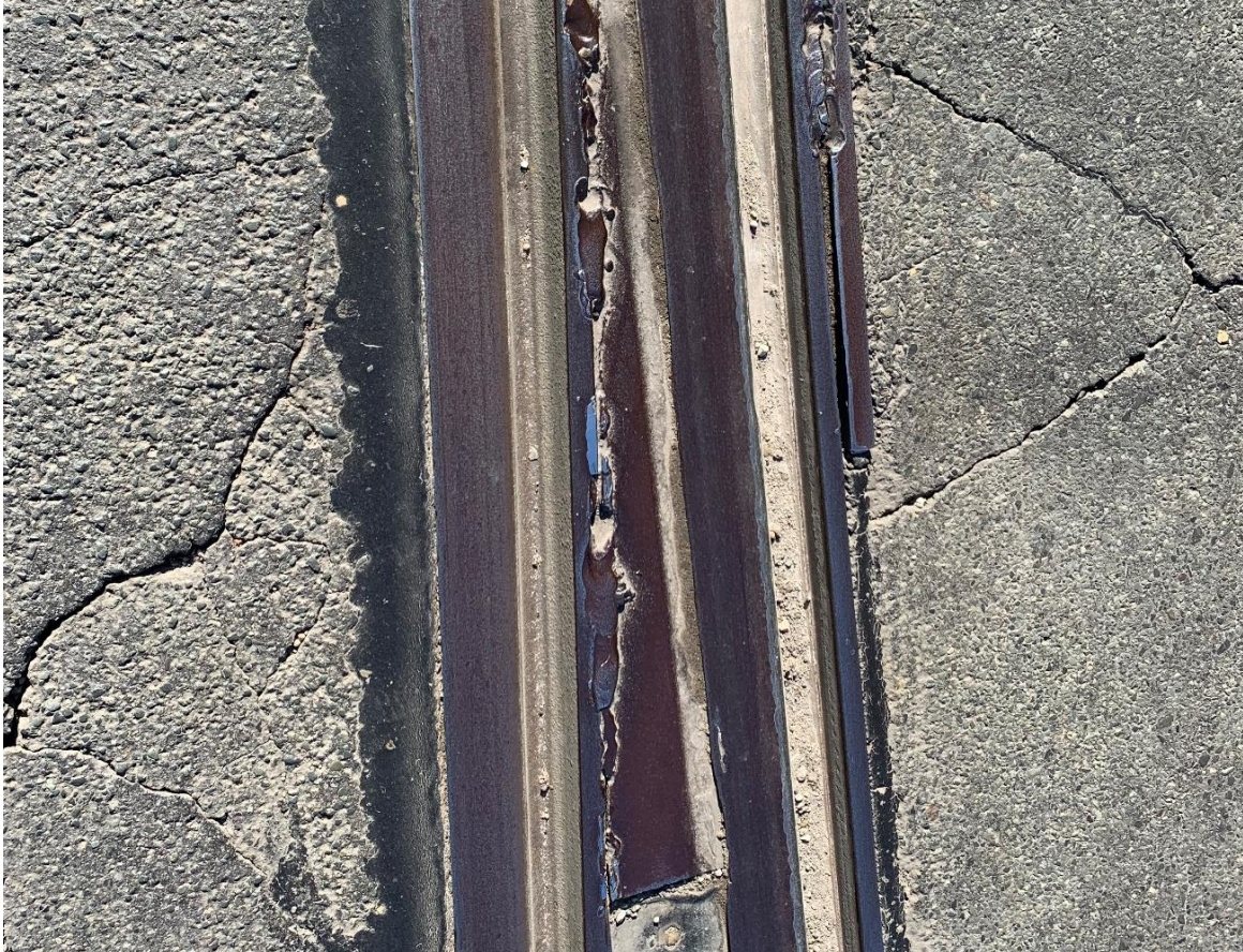
Abbildung 11: Verschleiß am Gleisdreieck Pirkheimerstraße
