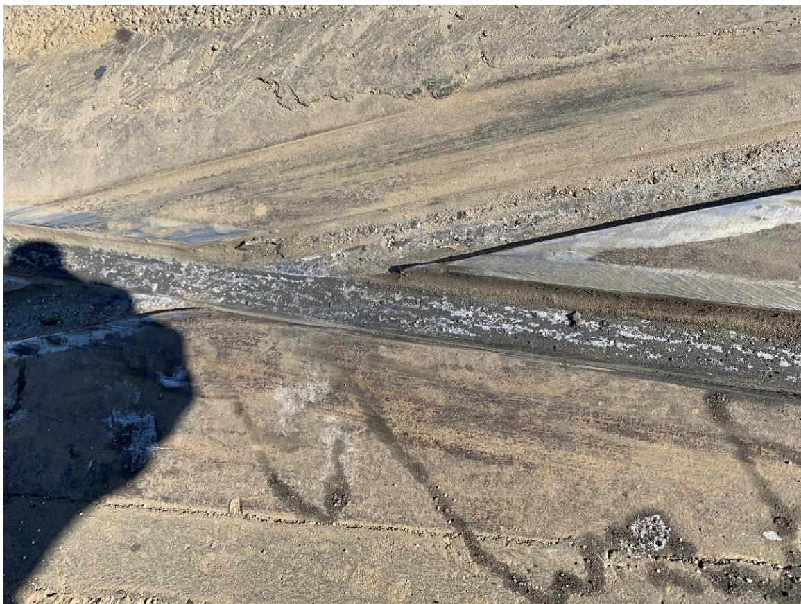
Abbildung 3: Verschleiß an Gleiskreuzung Rathenauplatz
