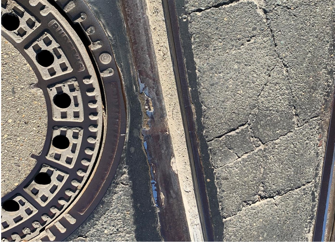
Abbildung 9: Verschleiß am Gleisdreieck Pirckheimerstraße
