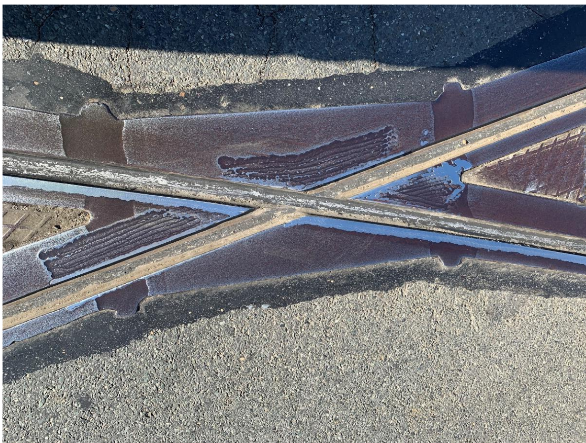
Abbildung 4: Verschleiß an Gleiskreuzung Rathenauplatz
