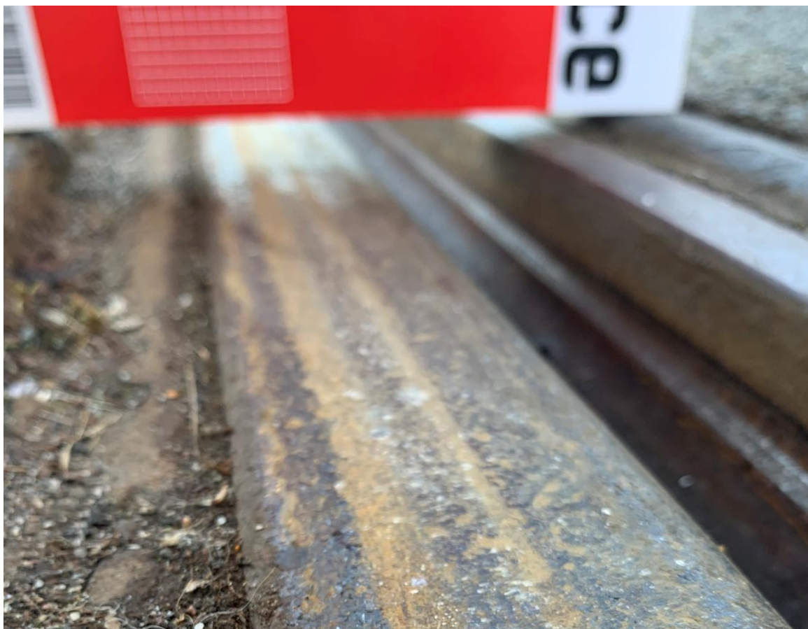
Abbildung 16: Verschleiß am Gleise entlang Berliner Platz
