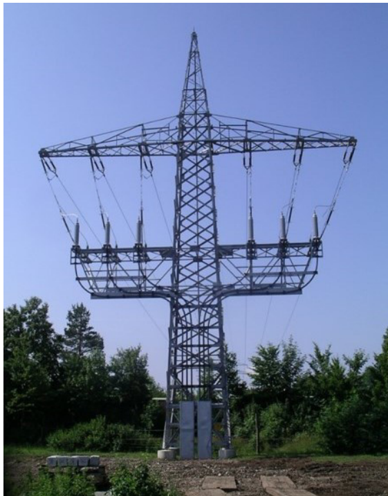
Abbildung 7: Beispiel eines Kabelübergangsmastes
