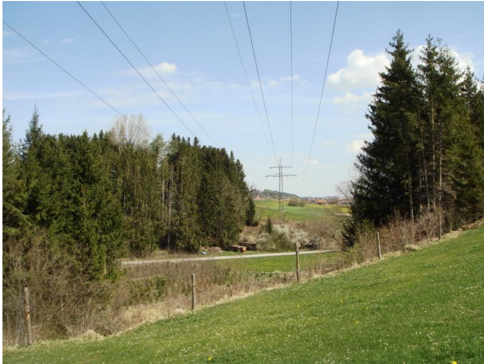
Foto 3 Nordwestabschnitt bei Querung der Ingenrieder Straße, Blickrichtung Nordost, 18.04.2020: Schneise durch Hangwald an alter Bahnlinie, in der Bildmitte Maststandort 60, im Hintergrund Schwabssoien
