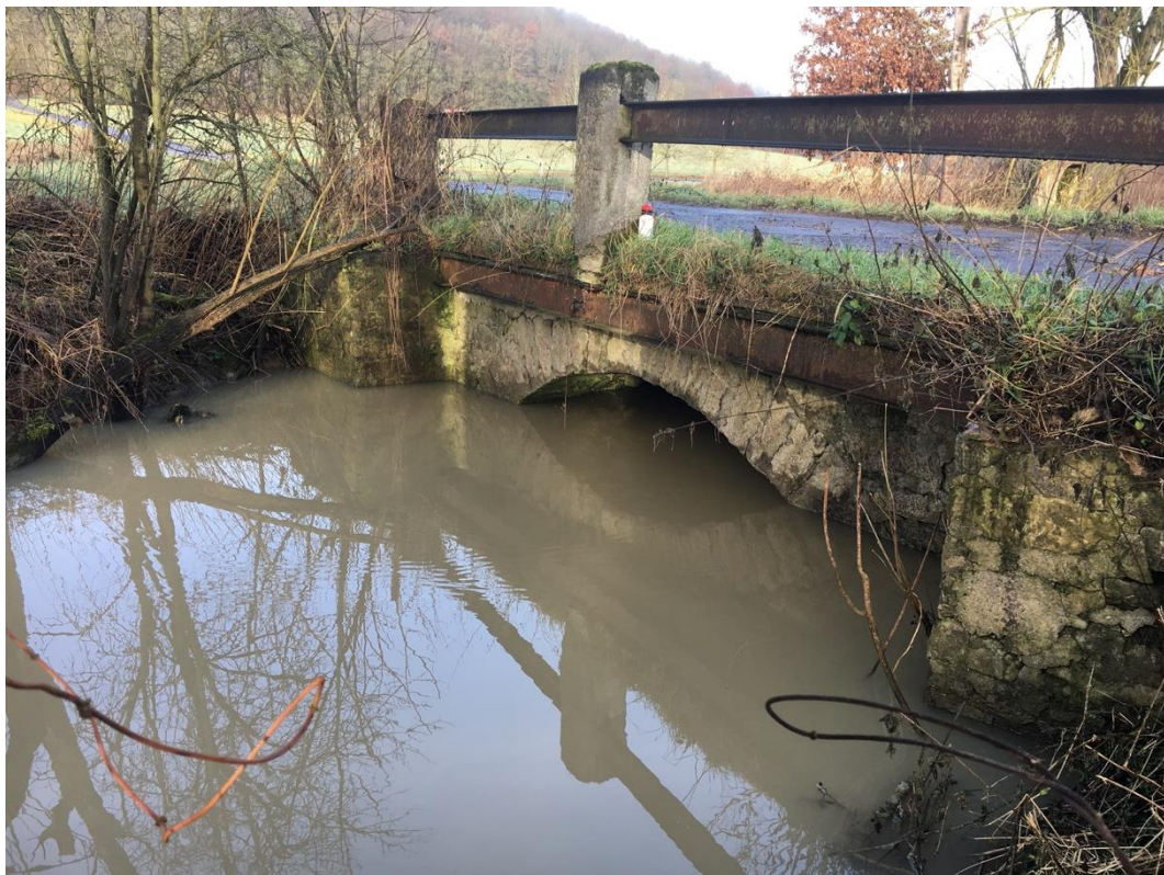
Abb. 15: Öffentliche Feld- und Waldwegbrücke über den Krebsbach mit Hochwasser.
