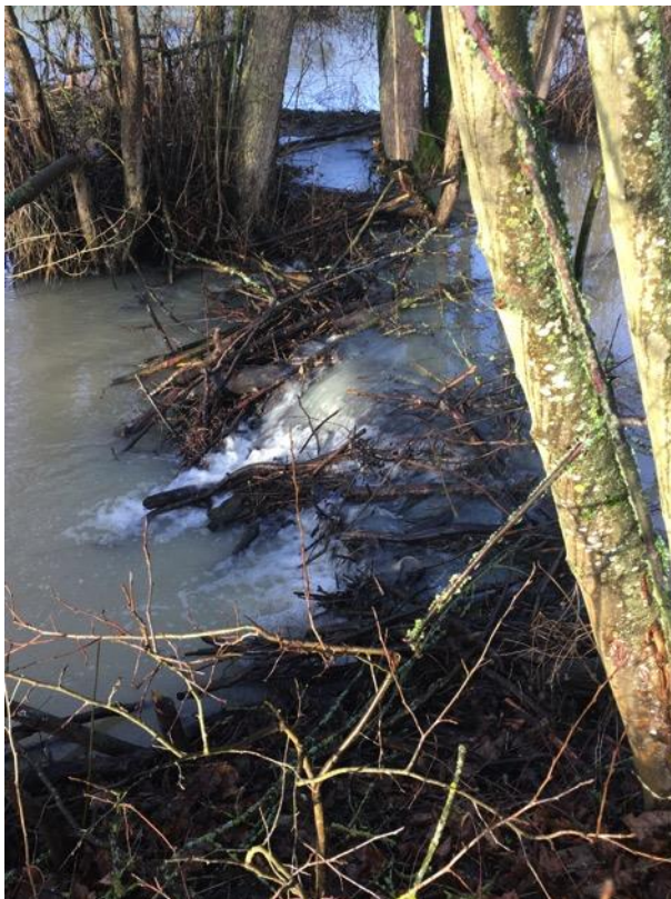
Abb. 57: Dammbauwerk des Bibers unterhalb des Krebsbachdurchlasses
