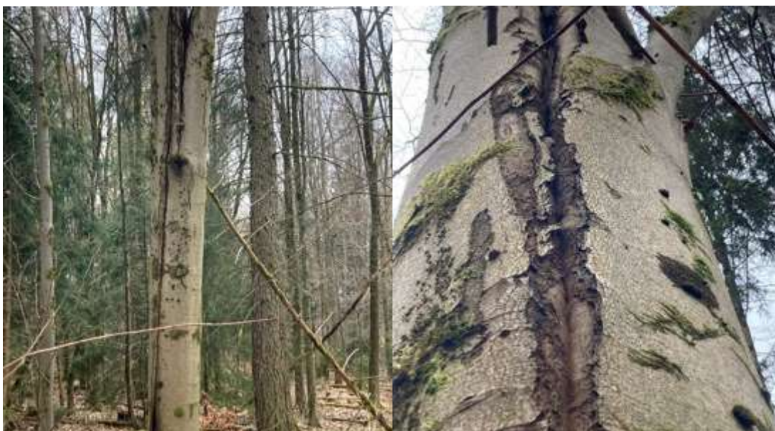
Abb. 19: Große Spalte an einer Buche
