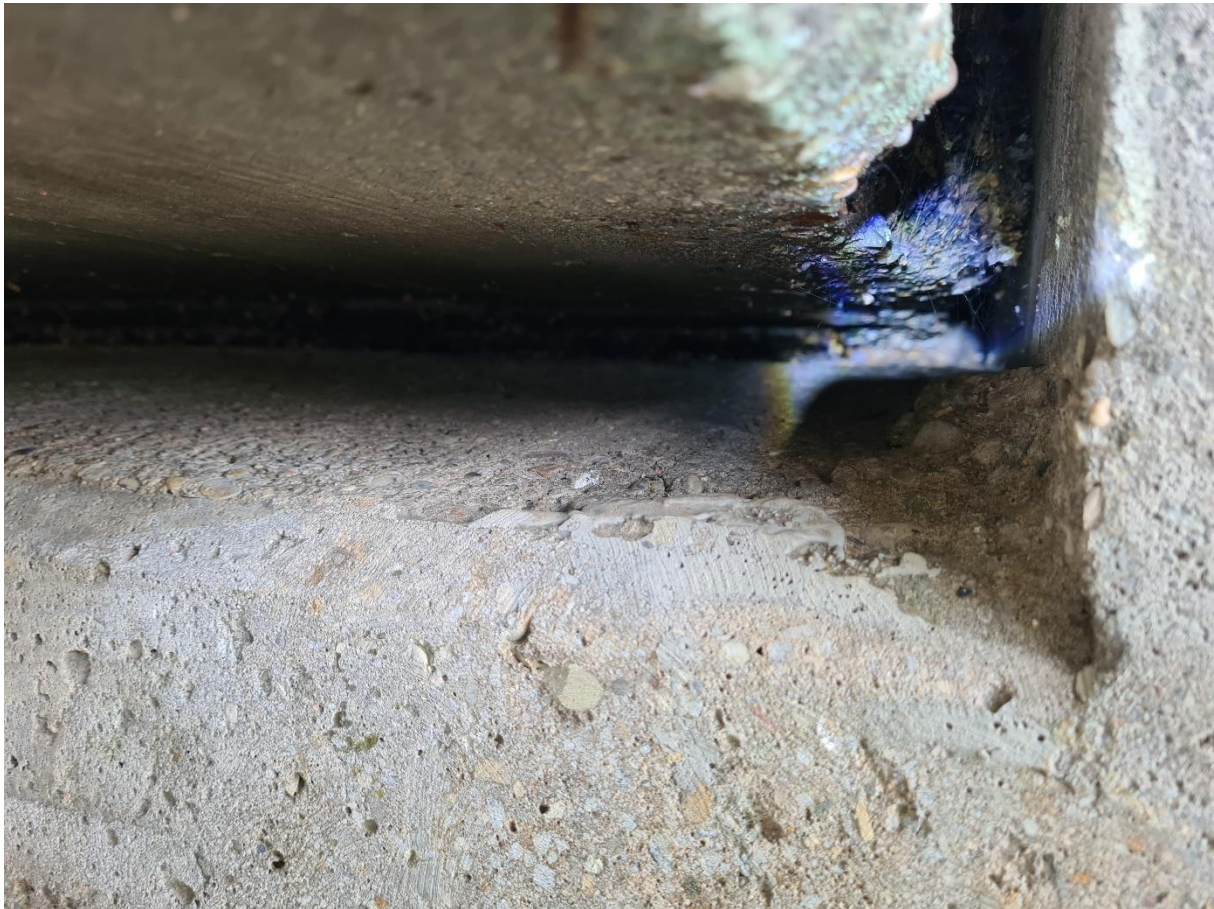
Abbildung 9: Hohlräum unter dem Überbau des östlichen Bauwerks (April 2022).
