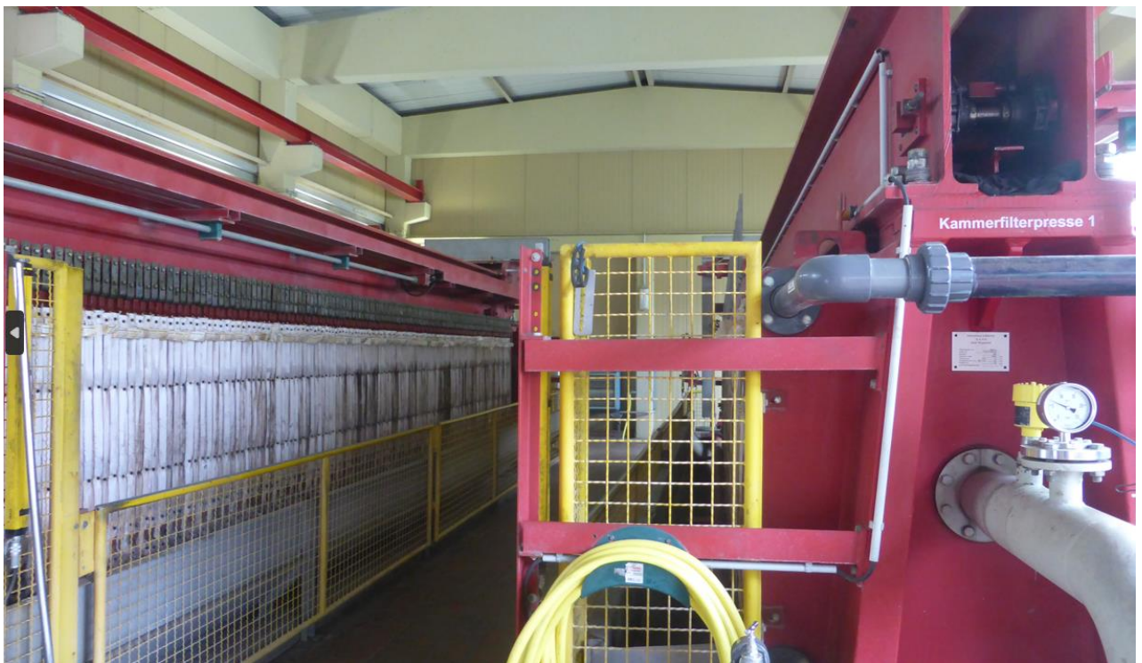
Foto 5.2-5: Schlammentwässerung (vgl. Nr. 17 Abbildung 5.2-1)
