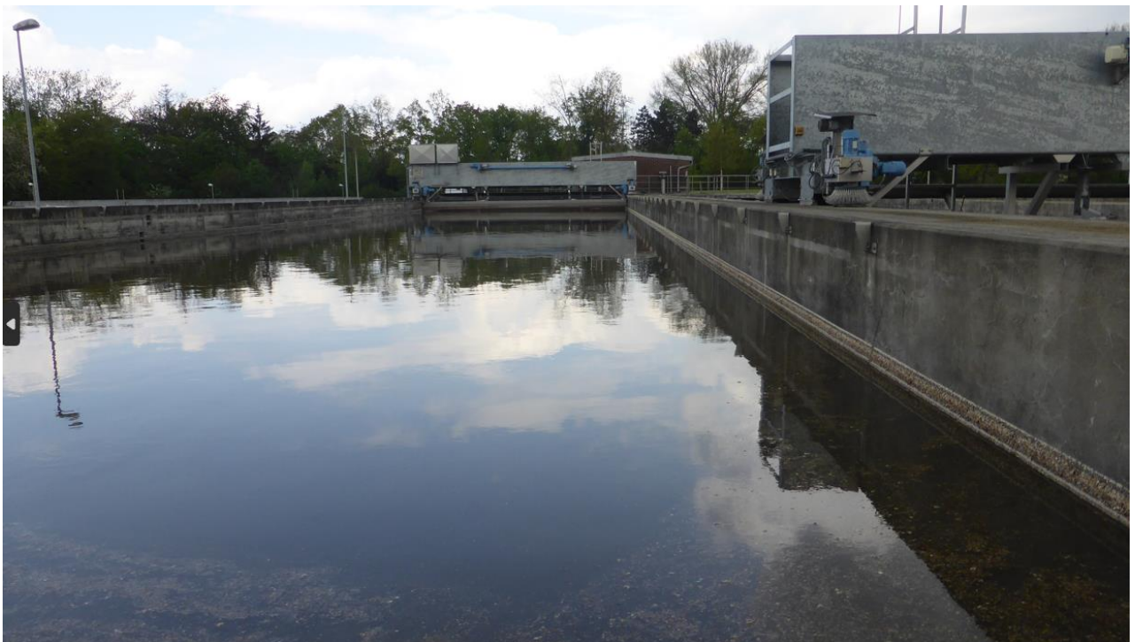
Foto 5.2-4: Vorklärbecken im Osten (vgl. Nr. 5 Abbildung 5.2-1)
