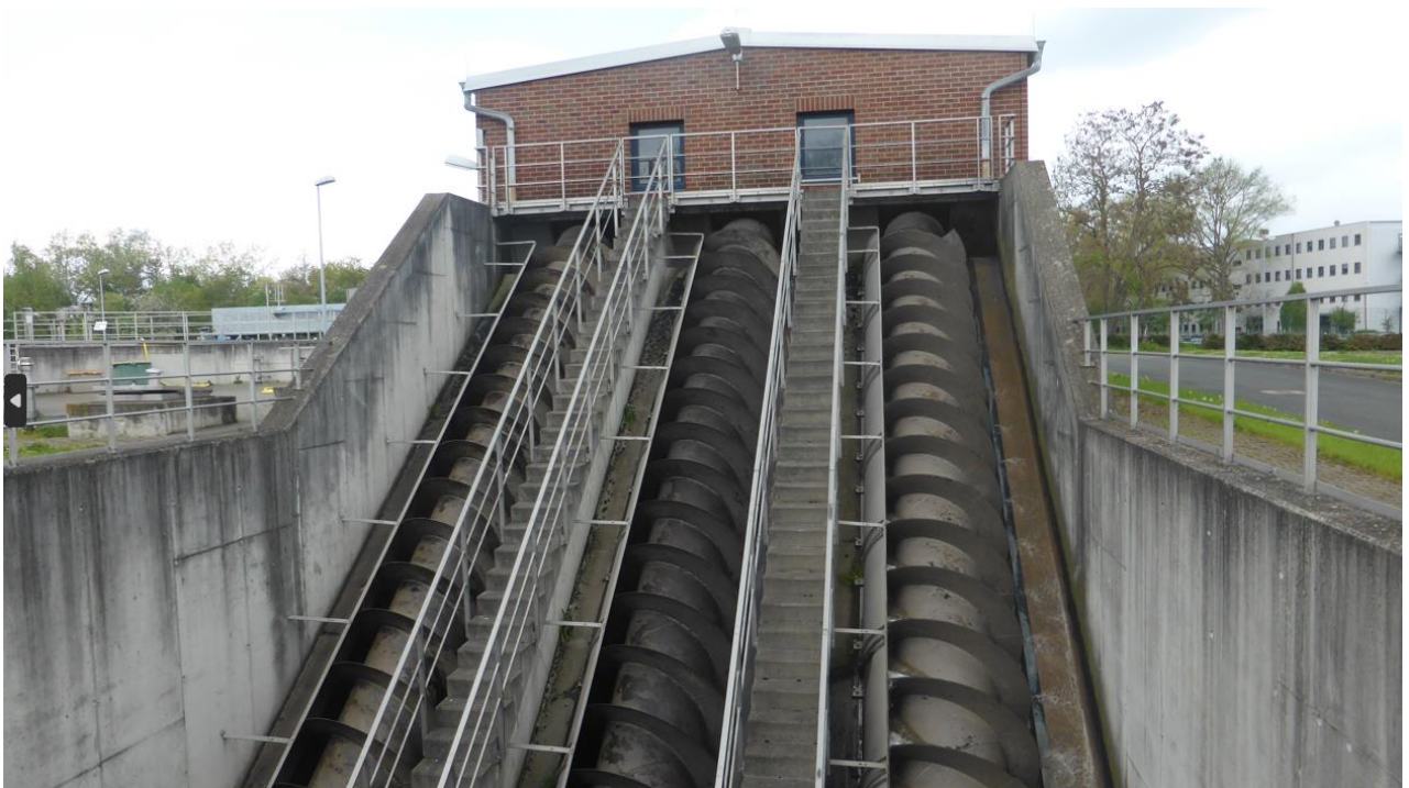
Foto 5.2-2: Schneckenhebewerk im Osten (vgl. Nr. 3 Abbildung 5.2-1)
