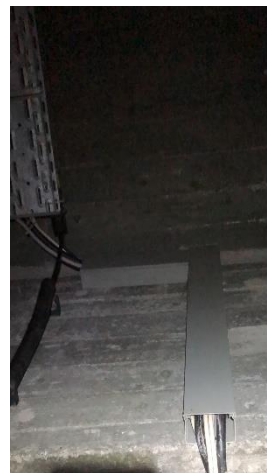
Abb. 7: Kabelschacht an den Wänden
