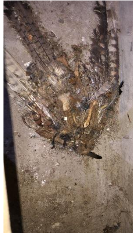
Abb. 18: toter Turmfalke Pfeiler 4 Ost
