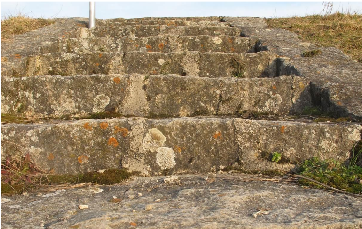
Abb. 38: von Flechten besiedelte Stufen einer Betontreppe.
