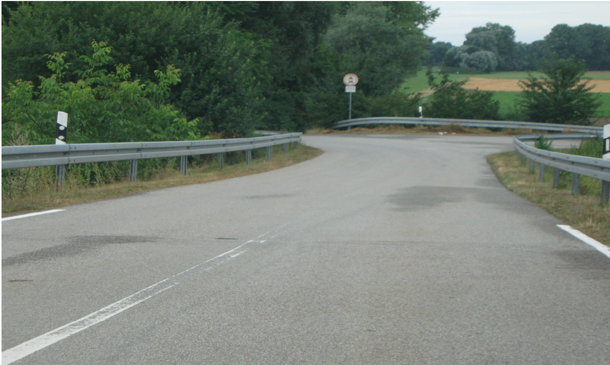
Abbildung 7: Blickrichtung Westen: Zufahrt nach Öberau, Bereich nach der Abfahrt aus der Linksabbiegespur der Westtangente vor WSV
