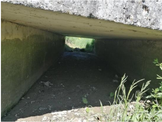
Abbildung 9 Kein geeignetes Sommerquartier für Fledermäuse
