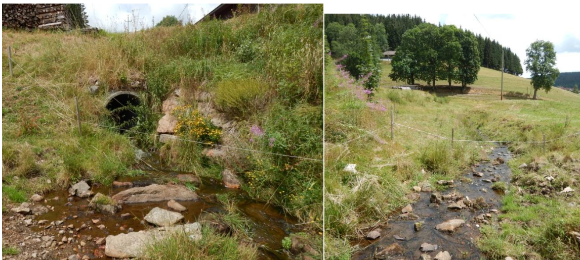
Abbildung 9: Verrohrter Abschnitt des Reibschentalbachs und sein weiterer Verlauf durch eine Weide unterhalb der Maßnahmenstrecke.
