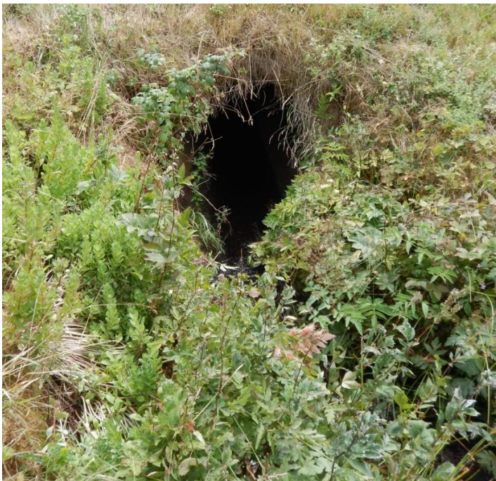
Abbildung 6: Die zum Teil sehr langen und engen Verrohrungen an den Wegquerungen des Rohrbachs können ein Wanderhindernis für viele Arten darstellen.
