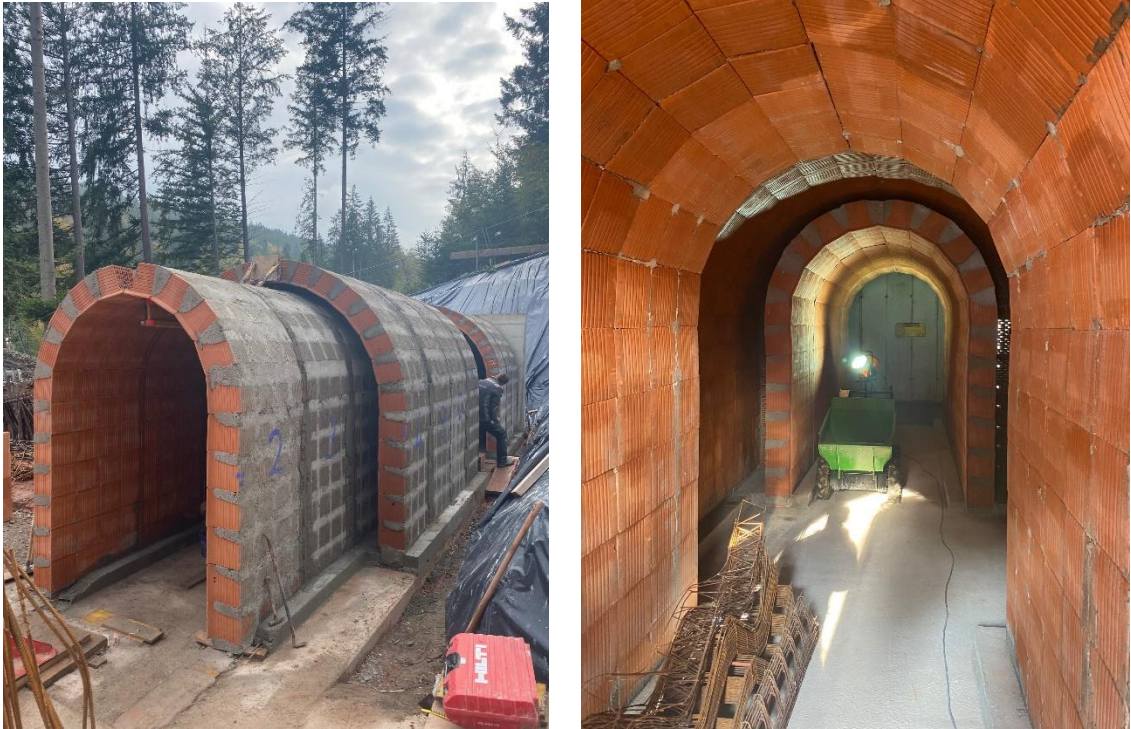
Abbildung 5: Tonnengewölbe-Fertigelement für das Fledermausersatzquartier (Quelle: Zweckverband Hermann-Hesse-Bahn).
