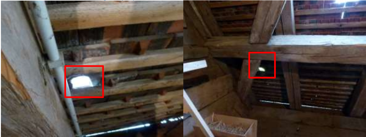
Dachbereich mit offenen Ziegeln (rot)
