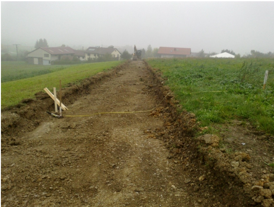
Abb. 45: Ausgekofferte Trasse eines herausfallenden Schotterweges
