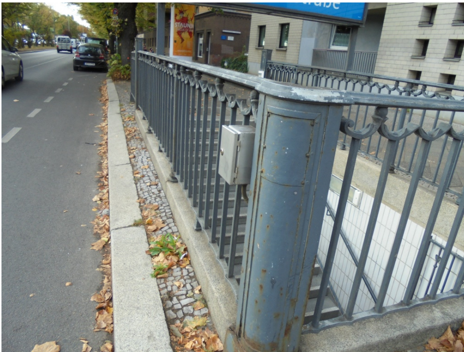
Abb. 22: Detailaufnahme von der Anschlussstelle Feuerwehr-Gebäudefunk am Ausgang I/1
