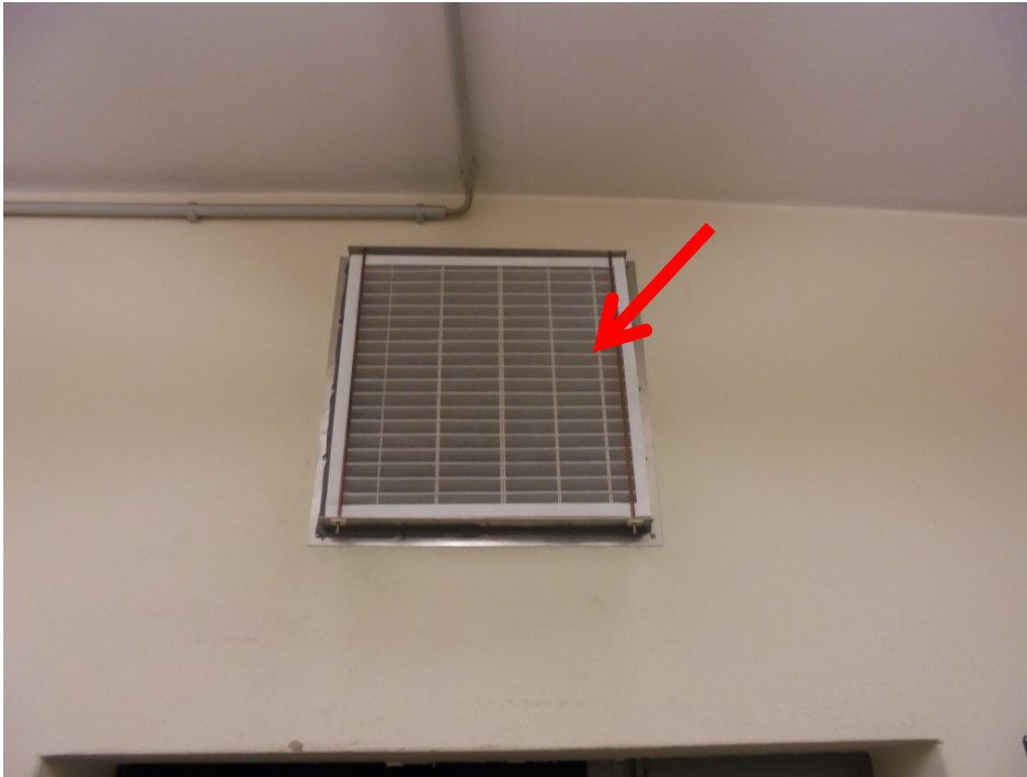
Abb. 14: Übersichtaufnahme einer brandschutztechnisch nicht geschotteten Lüftungsöffnung in Raum 101
