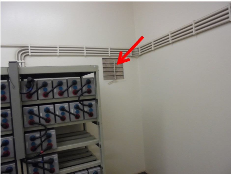
Abb. 18: Übersichtaufnahme einer brandschutztechnisch nicht geschotteten Lüftungsöffnung im Batterieraum Raum Nr. 205.1 in Richtung Gleis 1
