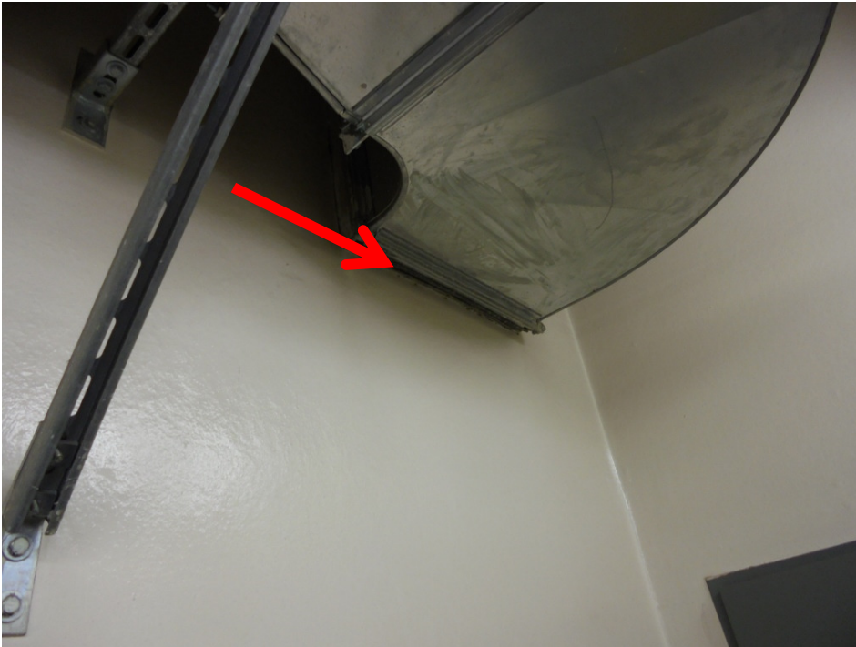
Abb. 17: Übersichtaufnahme einer brandschutztechnisch nicht geschotteten Lüftungsöffnung in Raum 205 in Richtung Gleisgang
