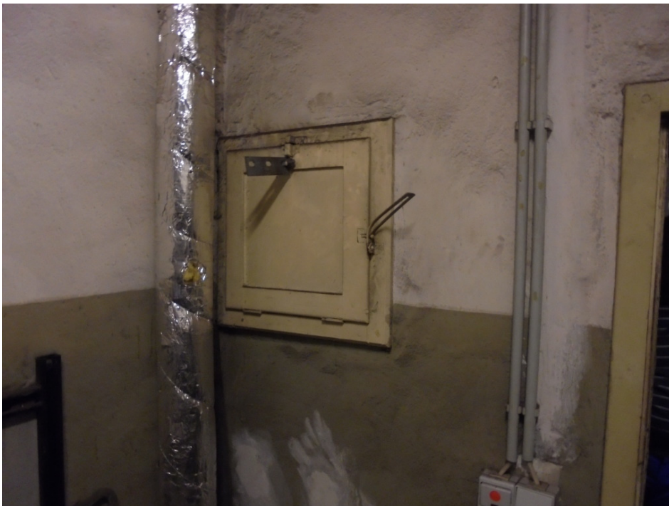
Abb. 12: Übersichtaufnahme einer brandschutztechnisch nicht geschotteten Lüftungsöffnungen in Raum 201
