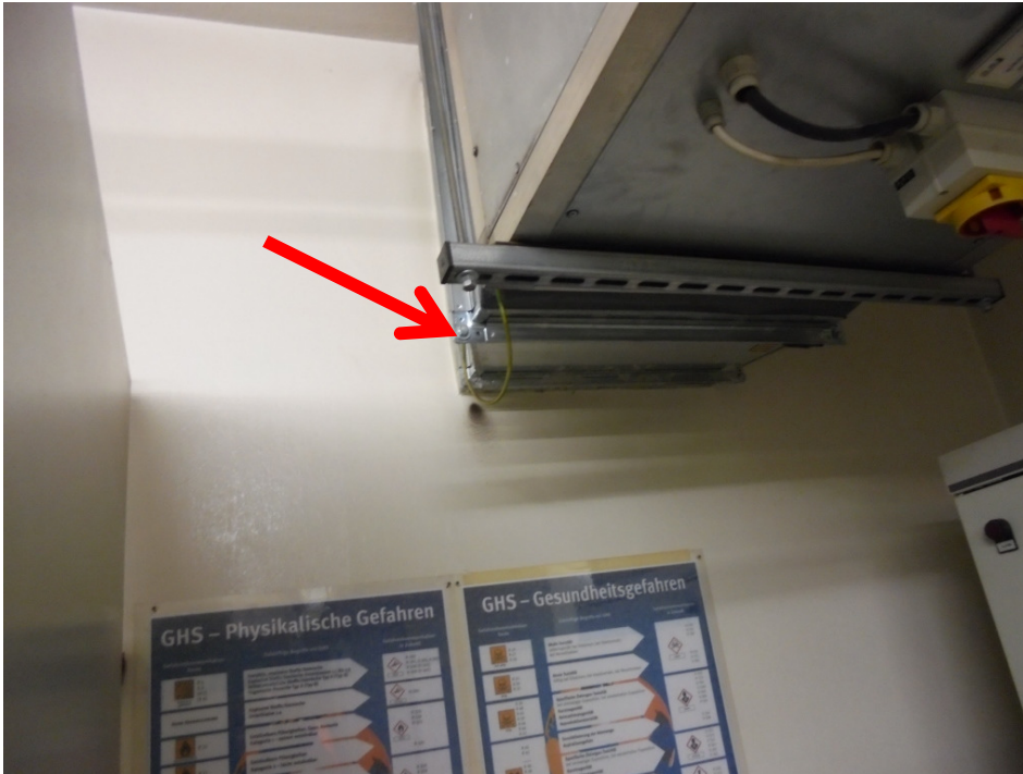
Abb. 15: Übersichtaufnahme einer brandschutztechnisch nicht geschotteten Lüftungsöffnung in Raum 205 in Richtung Gleis 1
