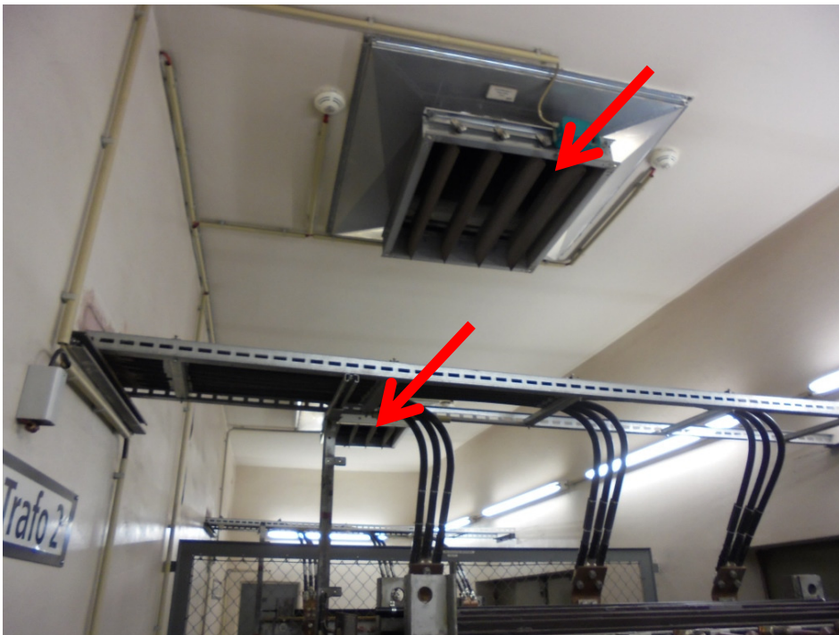
Abb. 16: Übersichtaufnahme brandschutztechnisch nicht geschotteter Lüftungsöffnungen in der Decke von Raum 206
