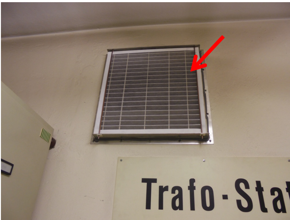
Abb. 13: Übersichtaufnahme einer brandschutztechnisch nicht geschotteten Lüftungsöffnung in Raum 101
