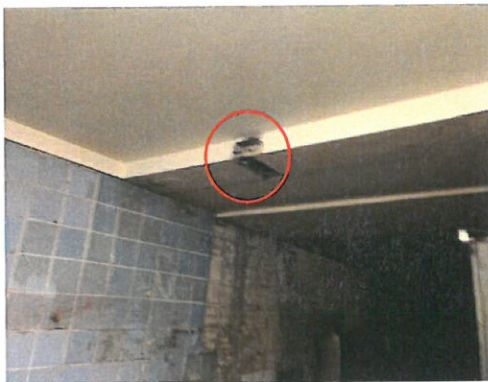
Abbildung 9 Beschädigte Wandverkleidung im östlichen Bereich der Station
