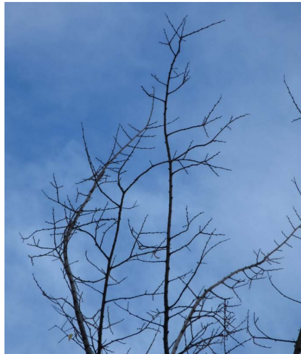
Abb.:17. Bsp. für unbelaubte Zweige mit gesund aussehendem Knospenbesatz, nicht alle zum Zeitpunkt der Ortsbesichtigung unbelaubten Zweige sind abgestorben
