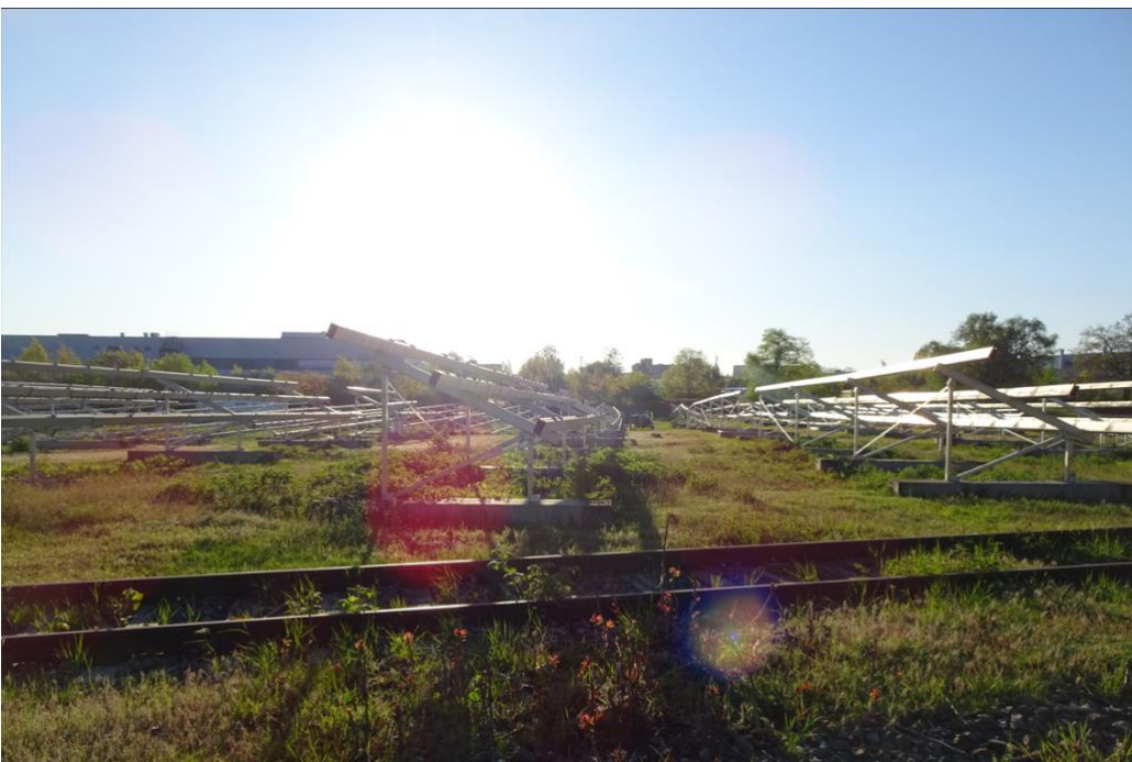
Abbildung 21: Die Befestigungskonstruktionen der Solarpaneele im zentralen Bereich des Untersuchungsraumes. Solarpaneele bereits demontiert. Blickrichtung Ost
