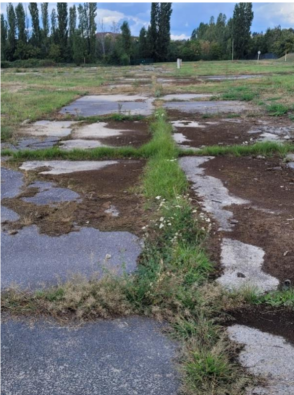
Abbildung 14: Teilversiegelter Weg mit Vegetation in den Zwischenbereichen der Betonplatten.
