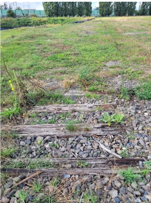
Abbildung 7: Stark verwittertes Gleisbett.
