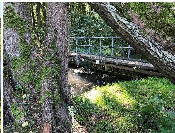
Abbildung 4.3: funktionsfähige Wehranlage im Dlugybuschfließ
