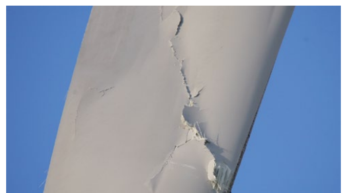
Schaden am Rotorblatt
