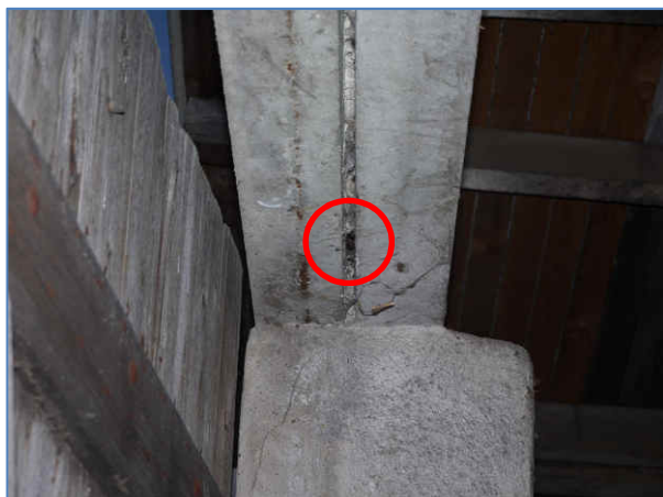
Abb. 4 Besiedeltes Spaltenquartier zwischen zwei Betonstürzen.
