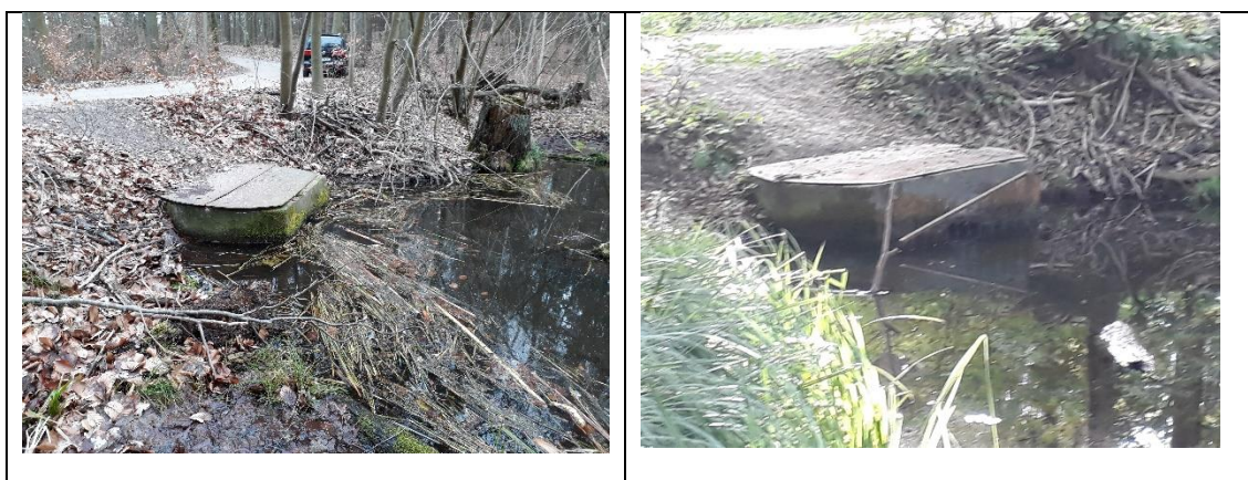
Abbildung 5-11: links - verstopfter Abfluss an den Kellen (20.02.2019); rechts - ähnlich hoher Einstau am 05.08.2020
