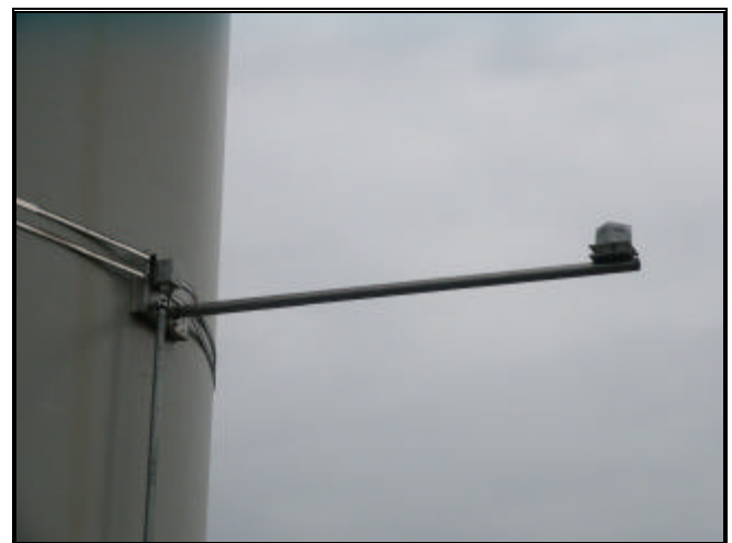
Bild 1: Sensor am Turm einer WEA
