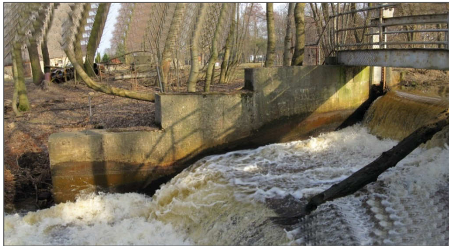
Abb. 4 Altwehr 17.33a mit Kaskadenboden
