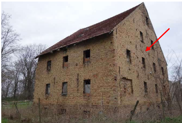
Abbildung 23: Nr.1, herausgebrochene Ziegelstücke an Gebäudefassade
